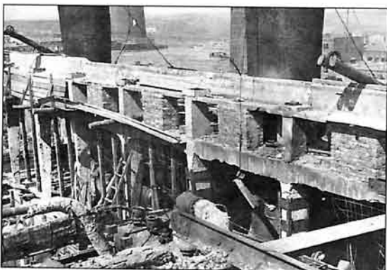
Вид на разрушения.
