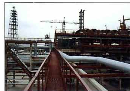
■ Центральный пункт управления аммиачного производства
